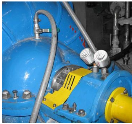
2개의 simalube 자동주입기가 펌프 베어링을 윤활합니다.
